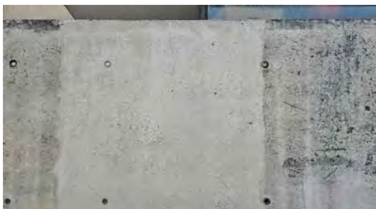
À Barcelone, ce bâtiment de 30 000 mètres carrés sur 5 étages bénéficie d'un traitement par photocatalyse en façade. Sur la partie droite, pas d'encrassement, ni de traces de COV ou encore de champignons noirs formés à cause de l'humidité n'apparaissent.
